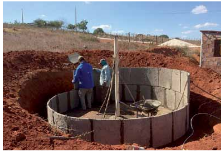
Com capacidade de 16 mil litros, a cisterna armazena a água da chuva
